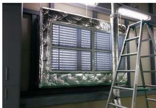
図4 外気侵入口のフィルター
