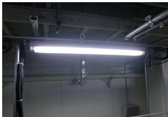
図2 飛散防止対策を施した蛍光灯
